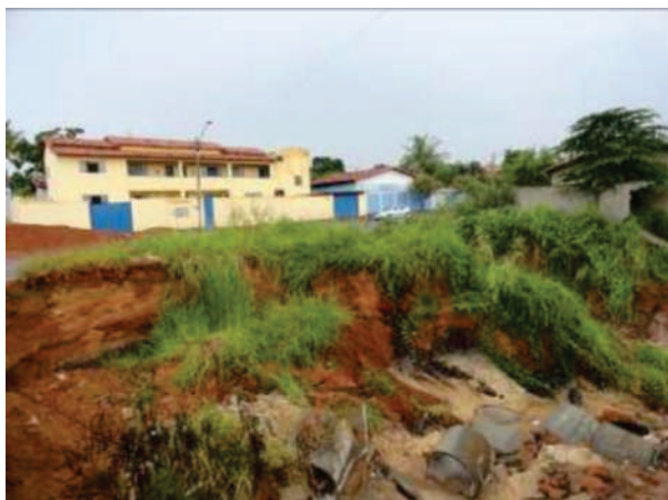
Foto 6. Vista Parcial da Voçoroca II – Taludes instáveis e presença de tubulações da galeria de água pluvial; destruição parcial da rua 35.
