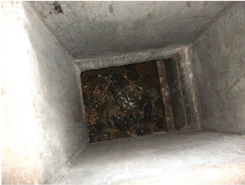
Figura 5: Canalização da nascente do ribeirão das Antas
