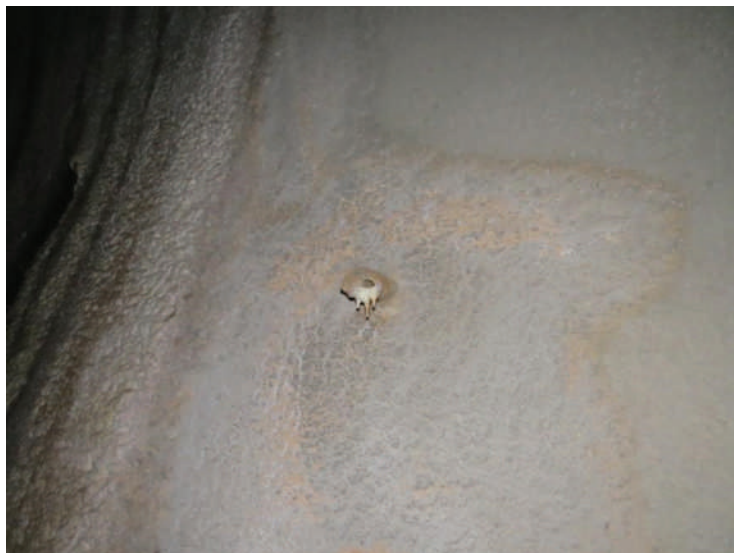
Figura 6: Detalhe na parede interna do túnel da ferrovia, uma “estalactite de túnel”, ocorre pela grande infiltração de água que passa pelo concreto retirando o calcário do mesmo, enfraquecendo-o e danificando a sua estrutura.
