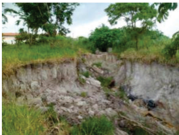
Foto 2. Vista parcial da voçoroca evidenciando taludes instáveis e movimentos de massa (fevereiro de 2014).
