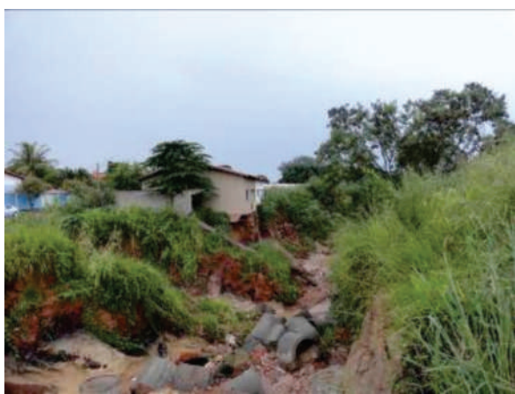
Foto 8. Vista Parcial da Voçoroca II – Solapamento destruindo uma residência, ao fundo da imagem; presença de tubulações da antiga galeria e assoreamento do leito do córrego.
