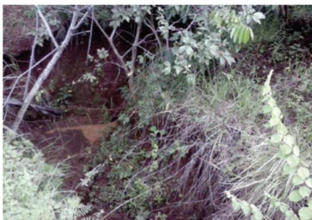
Figura 04 - Foto de cerca destruída dentro da erosão
