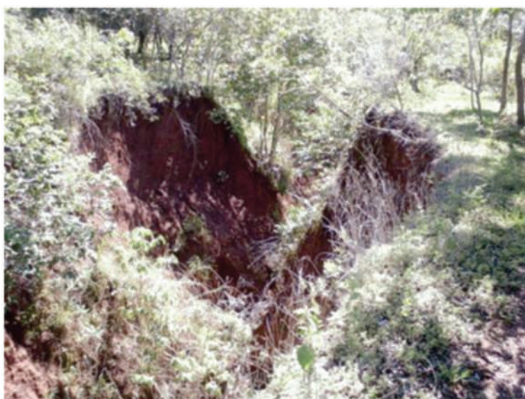
Figura 11- Foto da ravina principal, com aproximadamente 6 m de profundidade
