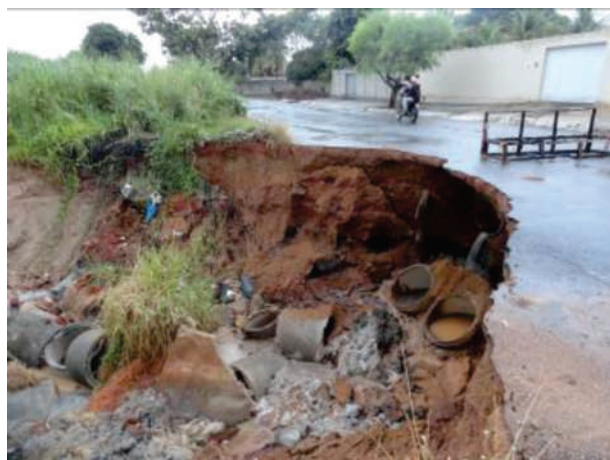
Foto 9. Vista Parcial da Voçoroca II – Solapamento da via pavimentada, destruição de galeria de água pluvial, riscos de destruição de residência e à segurança de transeuntes.
